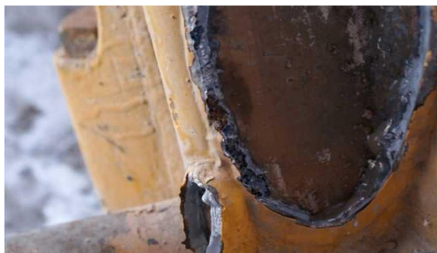
Рис. 2. Дефект сварного шва
