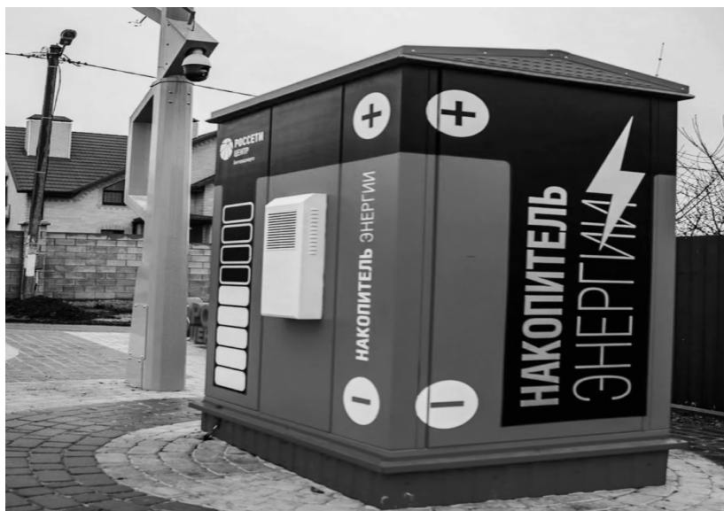
Рис. 4. Внешний вид накопителя энергии
