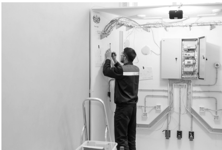
Рис. 4. Ячейки для электромонтажа [1, 2]
